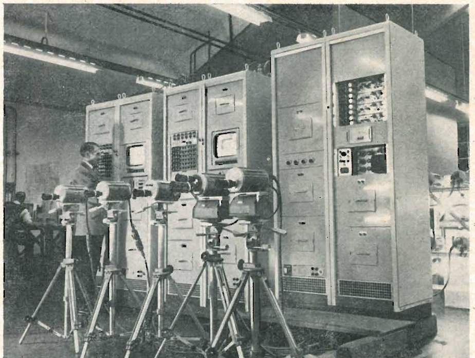
Alla centrale termonucleare di Trawsfynydd, nel Galles, sta per essere installato uno dei più grandi sistemi di televisione a circuito chiuso europei. Ben 58 telecamere comandate a distanza saranno impiegate per le operazioni di controllo e verifica del funzionamento della pila atomica. Il complesso è stato costruito dal gruppo PYE LTD di Cambridge (Inghilterra).
